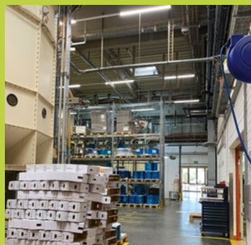
L'atelier de torréfaction « après » avec des lampes à LED
