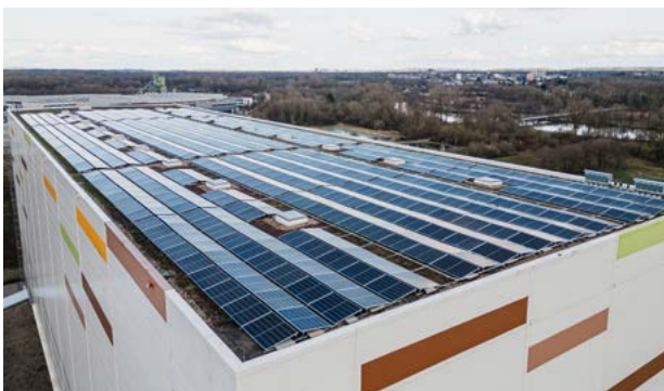
Installations photovoltaïques sur l'entrepôt à hauts rayonnages
